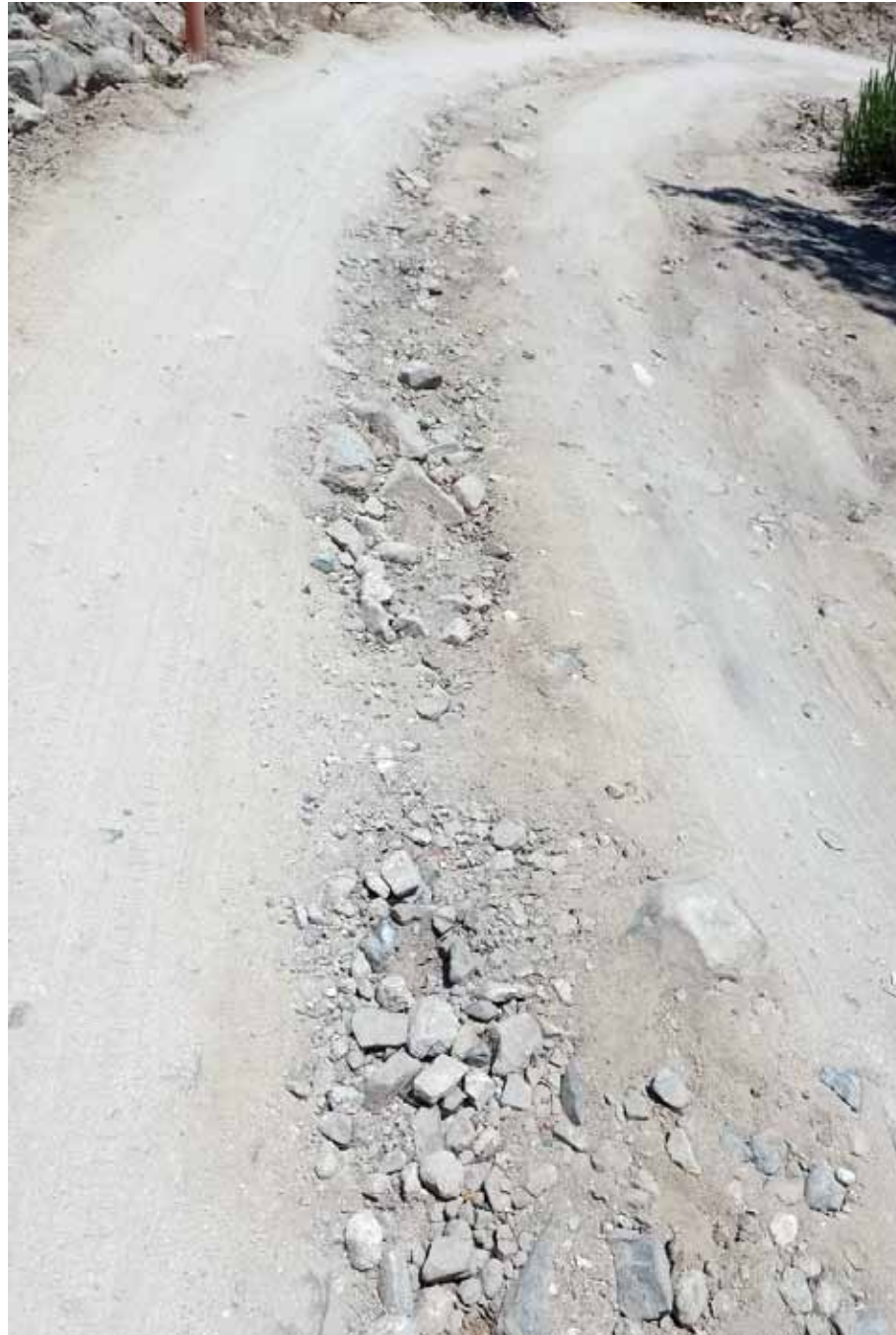
El camino que atraviesa Los Cristales se encuentra en muy mal estado.
