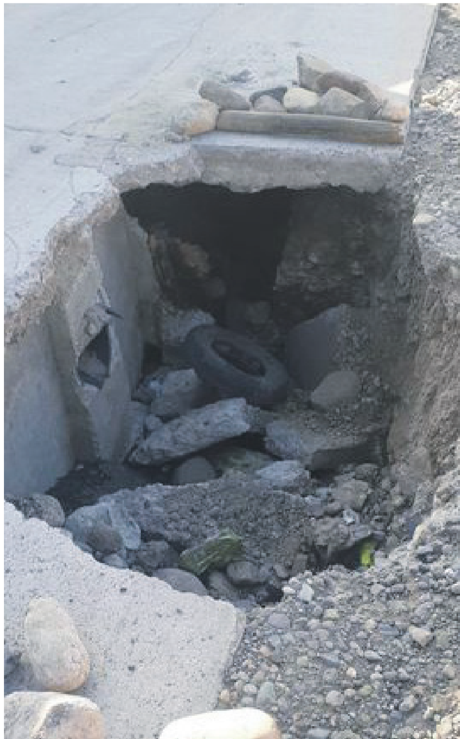
El socavón de calle Río Hurtado aún no es reparado, ni tampoco hay señales que adviertan del peligro.
