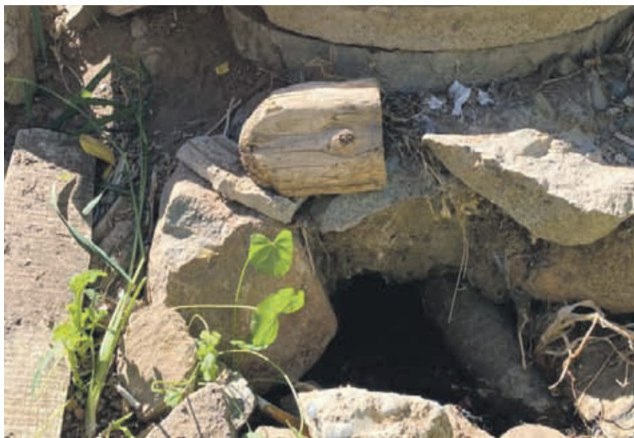
Cámaras abiertas del alcantarillado de aguas servidas afectan a las familias de Villa La Unión, en la localidad de Carachilla.
