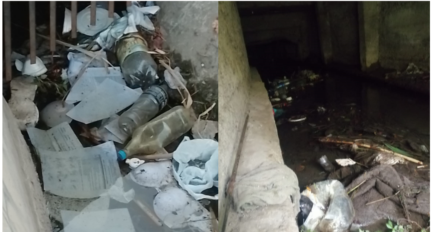
Actualmente el canal está lleno de desperdicios, lo que impide el correcto paso del agua y además se convierte en foco de ratas.
