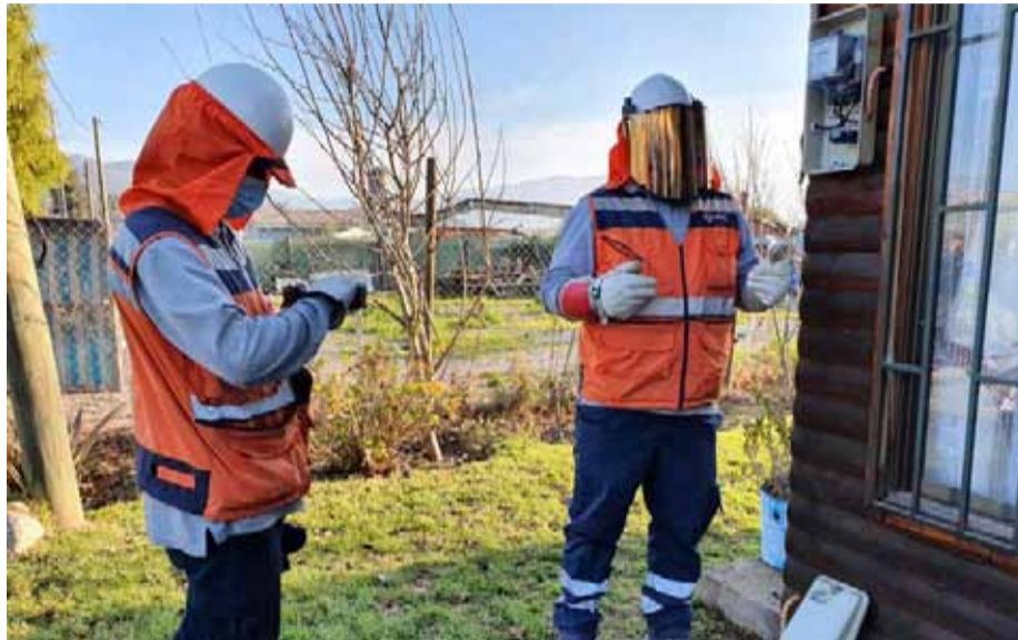
Los técnicos de CGE debieron desconectar la conexión eléctrica clandestina.
