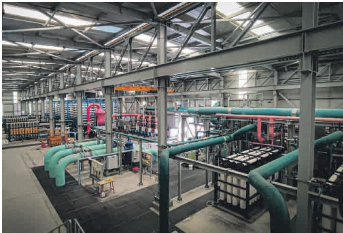
Puesta en marcha en 2022, esta infraestructura provee de agua al 75% de la población de la Región de Atacama.
