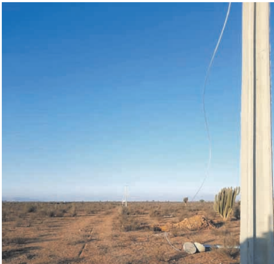
Antisociales robaron cables del tendido eléctrico en el sector de Llanos de Barraza. EL OVALINO
