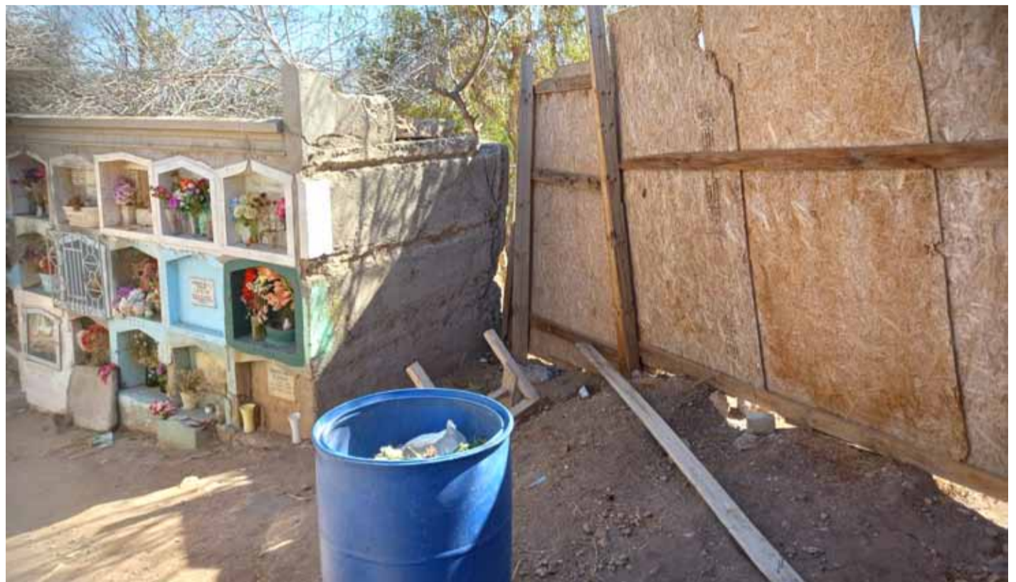
Una de las denuncias de la comunidad es el deterioro del cementerio de Punitaqui.
