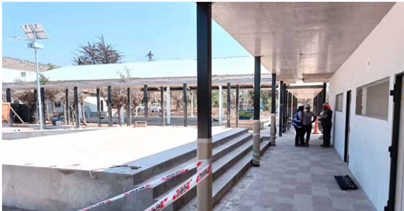
La Escuela San Antonio de la Villa de Barraza de Ovalle es una de los proyectos que ejecuta la empresa constructora Cosal en la Región de Coquimbo.
