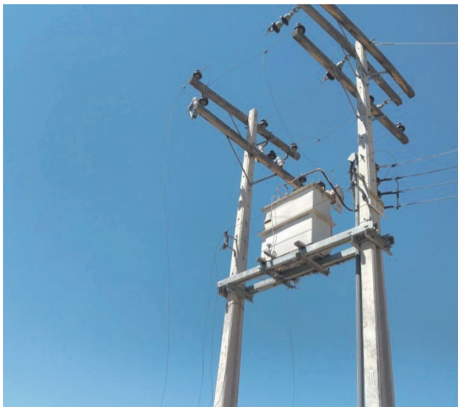
Un grupo de delincuentes robó 1.060 metros de cable de cobre desde las redes que posee la CGE en Ovalle y Monte Patria. CEDIDA
