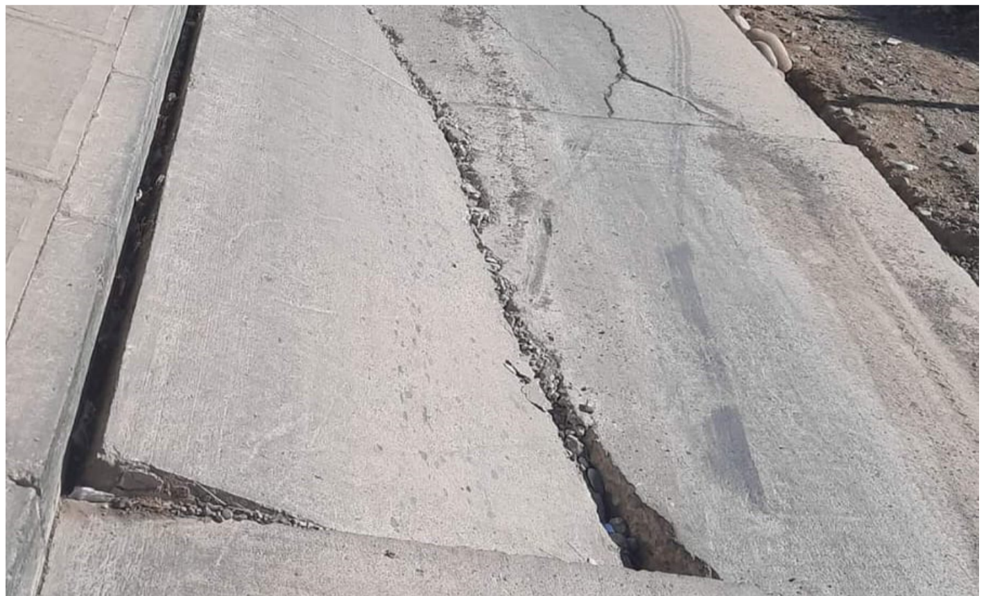
La calle Río Hurtado en Los Leíces actualmente está intransitable, ya que el pavimento y el socavón se han agravado.
