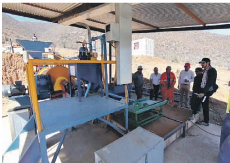
La planta fue materializada el año 2017 pero que por diversos problemas, presentó fallas en su estructura y equipamiento. La nueva inversión superó los 205 millones de pesos.
