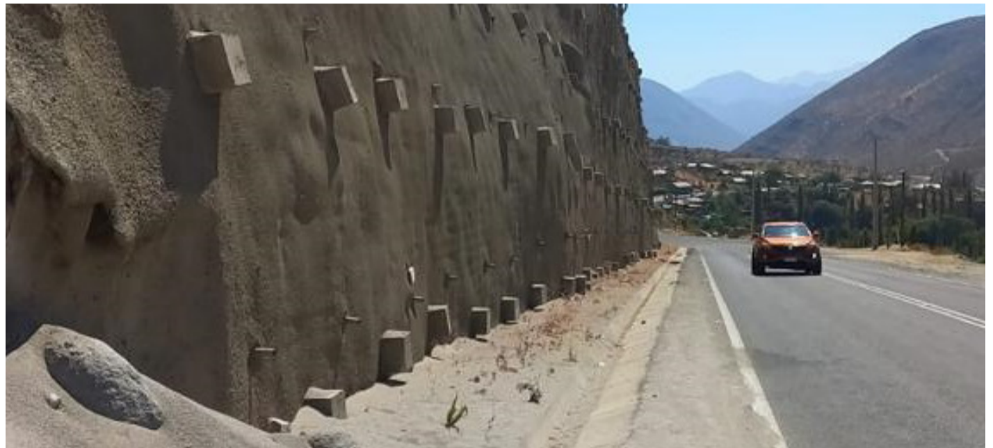
Así luce actualmente la Ruta D 597 entre Carén-Tulahuén.
