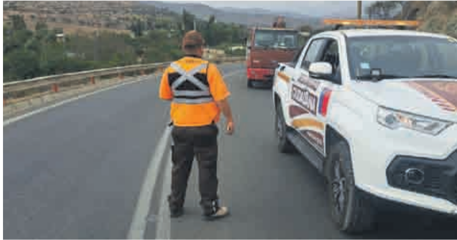
La semana pasada, se desarrollaron los trabajos asociados a la instalación de 7 postes de alumbrado público.
